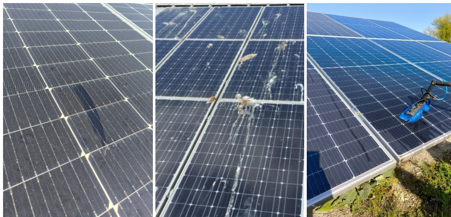
Widok zanieczyszczonych paneli i czyszczenie paneli PV
